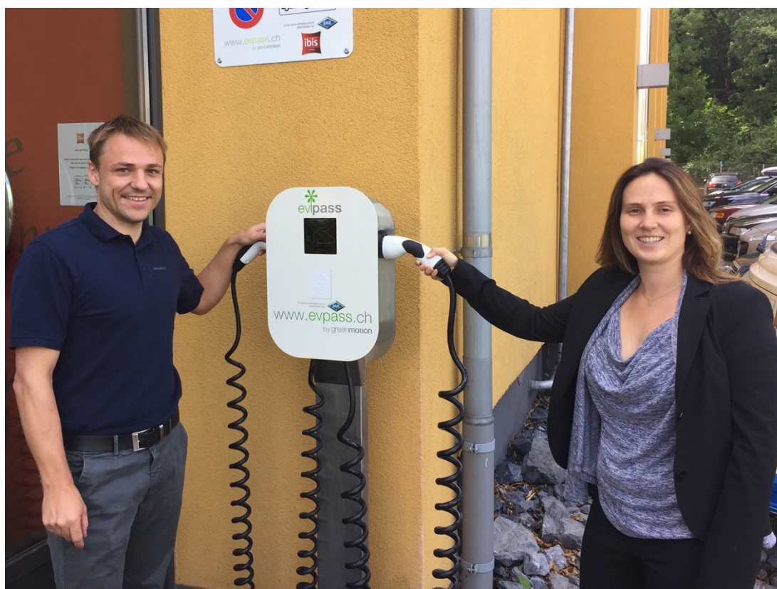
Freuen sich über die neu installierte Ladestation: Nina Brendolise, Direktorin Hotel Ibis Adliswil und Marc Messmer, Projektleiter E-Mobilität der SAK.
