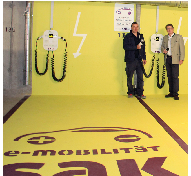
Freuen sich über die neu installierten Ladestationen: Hoteldirektor Christian Erpenbeck (rechts) und SAK Monteur Andreas Aebli..
